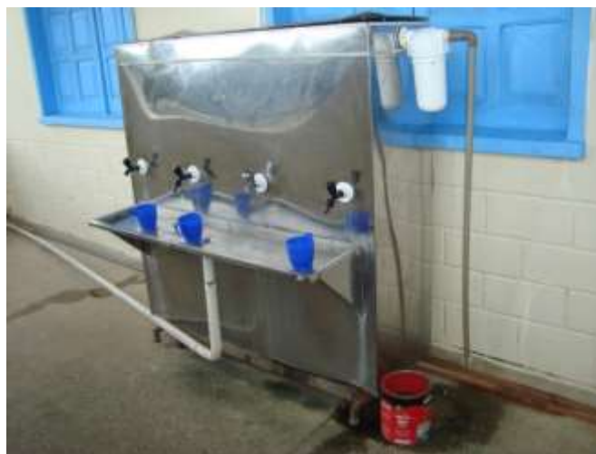
Figura 6. Bebedouro instalado na escola municipal da comunidade.
