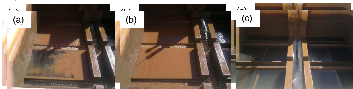
Figura 1 – (a) início da lavagem do filtro, (b) evolução do processo de lavagem e (c) etapa final da lavagem de Filtros da ETA Anápolis.
