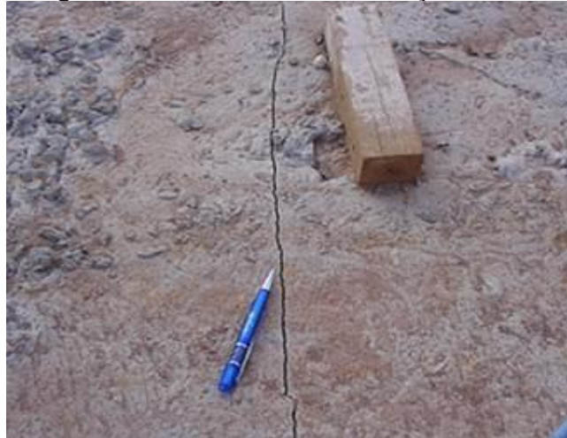
Figura 4 - Fissuras devido à dilatação térmica
