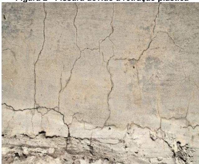
Figura 2 - Fissura devido a retração plástica
