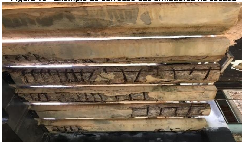
Figura 13 - Exemplo de corrosão das armaduras na escada
