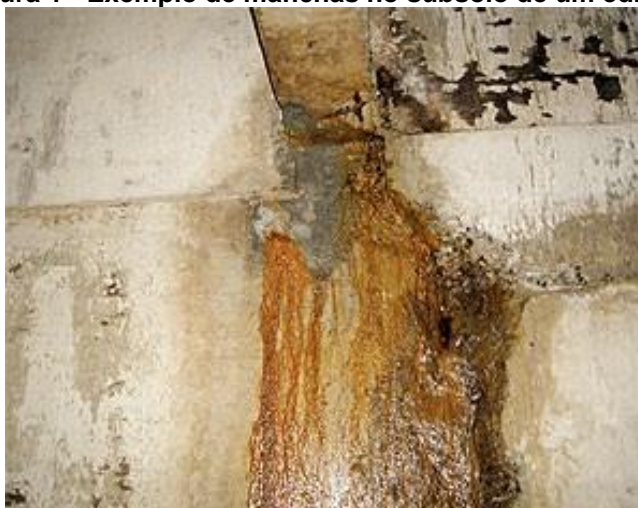
Figura 1 - Exemplo de manchas no subsolo de um edifício
