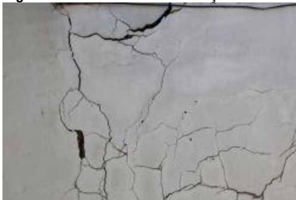
Figura 3 - Fissuras devido à retração hidráulica
