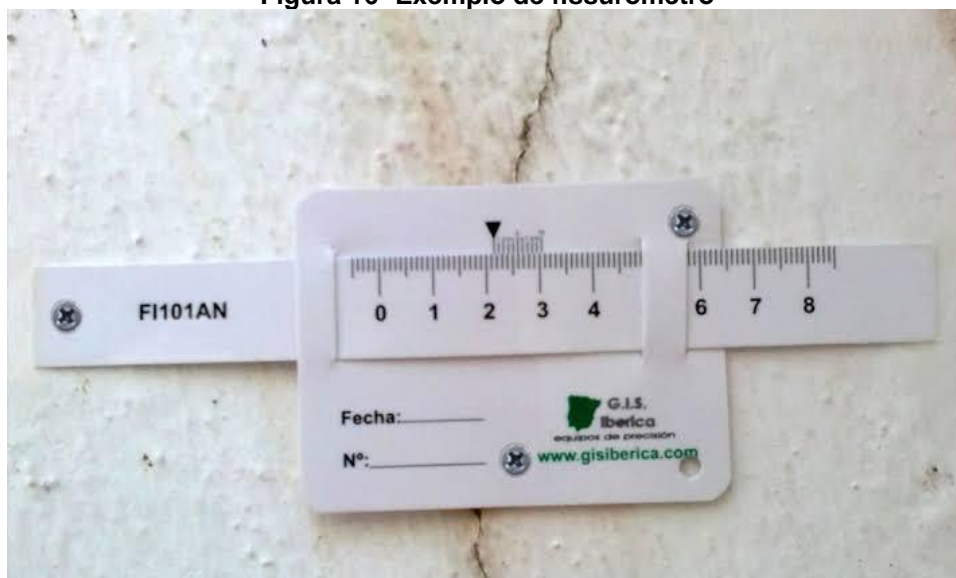
Figura 16- Exemplo de fissurômetro
