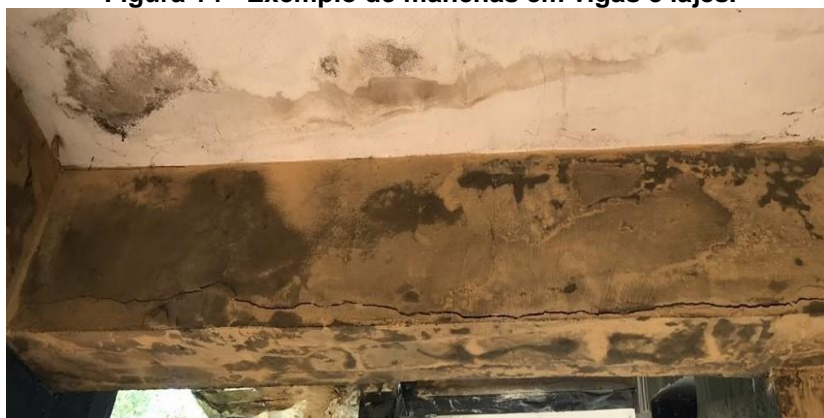
Figura 14 - Exemplo de manchas em vigas e lajes.
