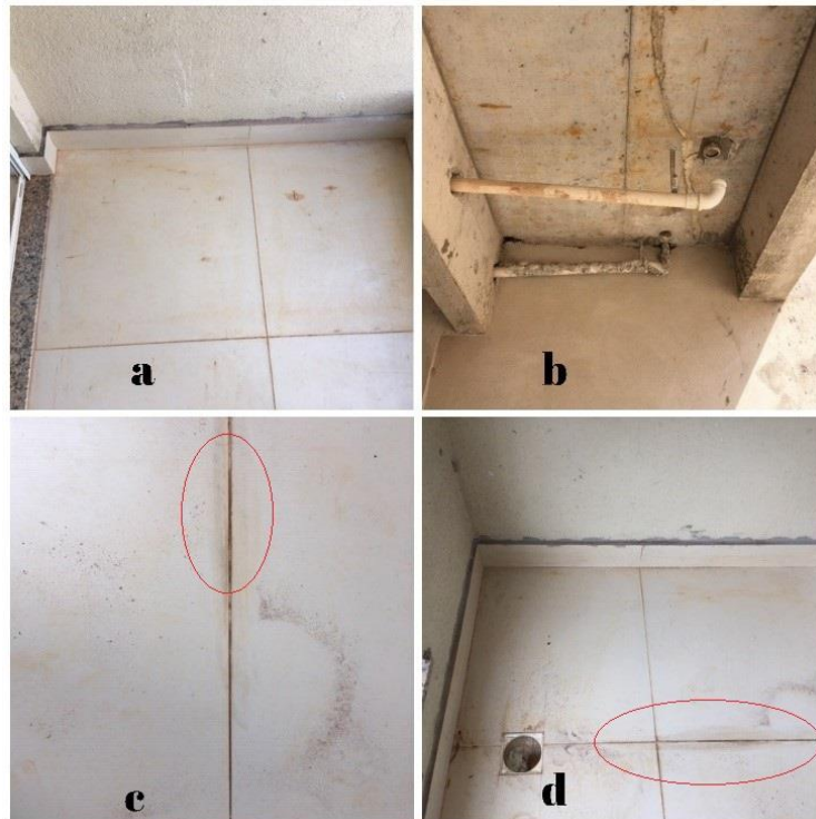
Figura 17 - Varanda cp1 (a) entrada da varanda (b) laje (c) detalhe próximo ao ralo (d) área próxima ao ralo
