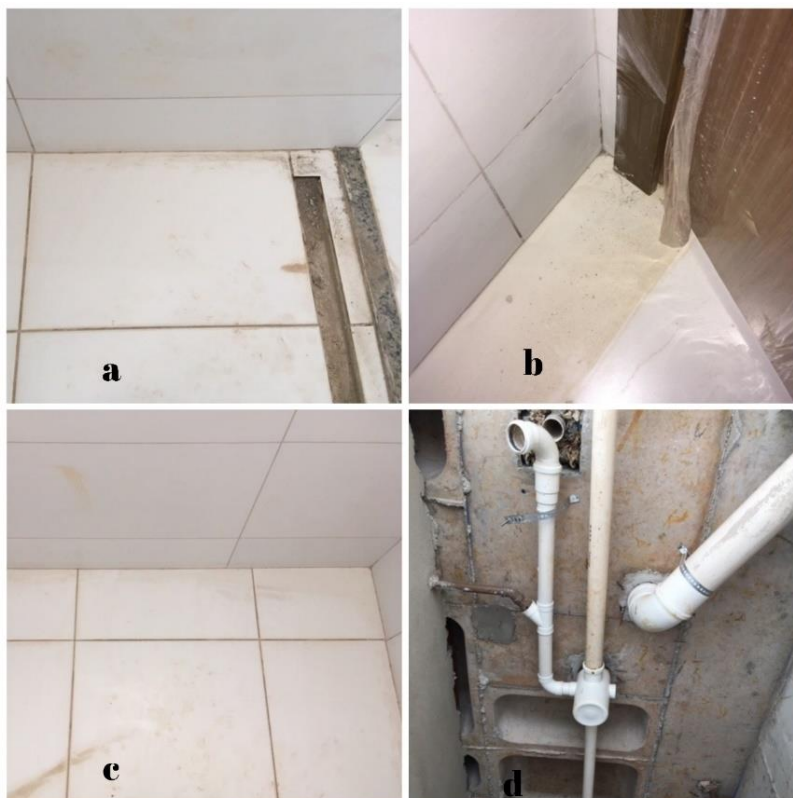
Figura 16 - Banheiro suíte cp2 (a) entrada do box (b) região atrás da porta (c) fundo do box (d) laje
