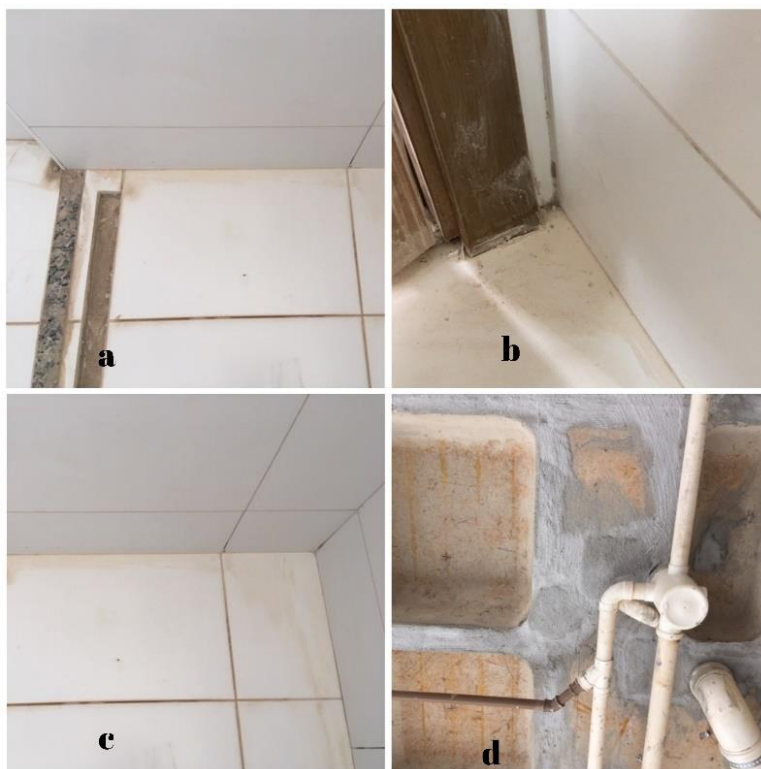
Figura 15 - Banheiro suíte cp1 (a) entrada do box (b) região atrás da porta (c) fundo do box (d) laje
