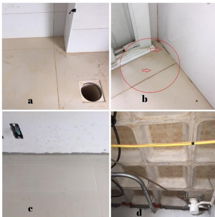
Figura 11 - Cozinha e lavanderia cp1 (a) cantos da lavanderia (b) divisa lavanderia/sacada (c) face exterior do balcão da cozinha (d) laje da lavanderia/cozinha
