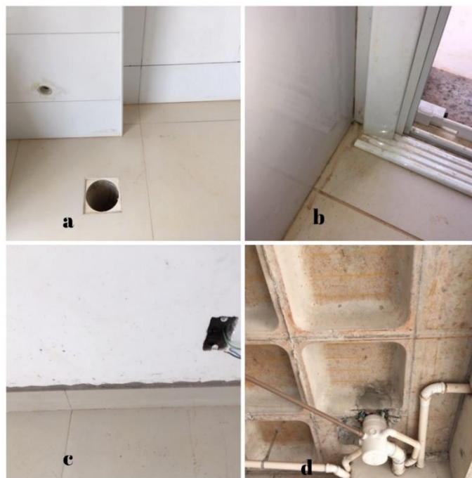
Figura 12 - Cozinha e lavanderia cp2 (a) cantos lavanderia (b) divisa lavanderia/sacada (c) face exterior do balcão da cozinha (d) face interior do balcão da cozinha
