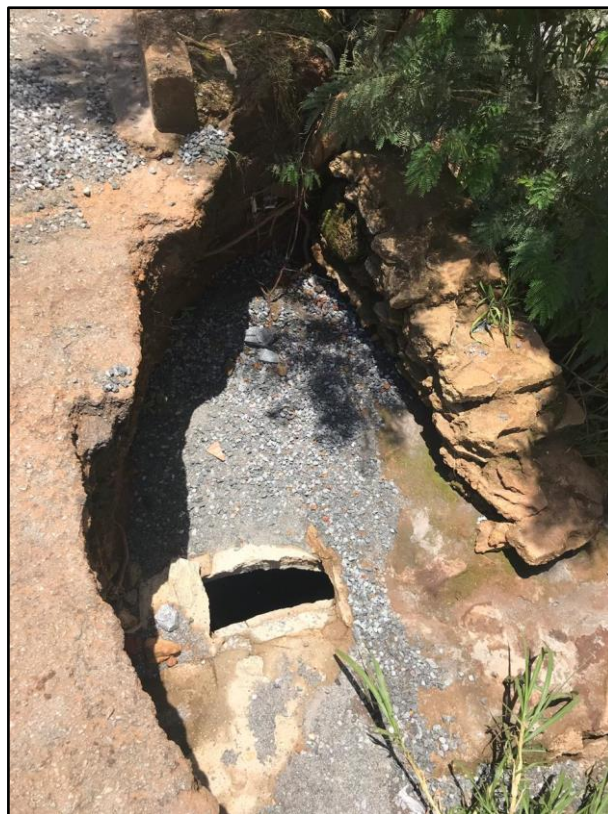
Figura 9 - Local onde asfalto cedeu e rompeu parte da aduela de drenagem
