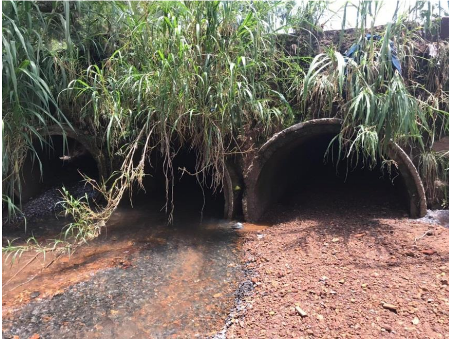
Figura 8 - Estado das aduelas Av. Isidoro Sabino
