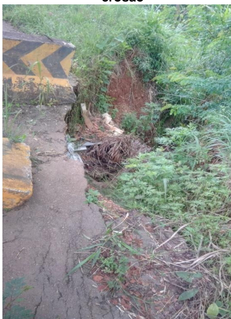
Figura - Acúmulo do entulho na erosão
