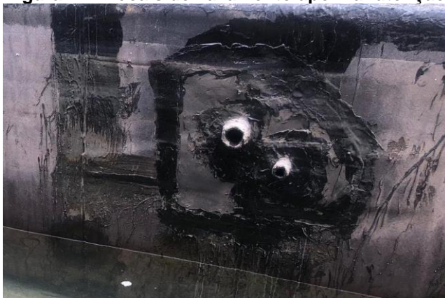
Figura 27 - Locais de vazamento após manutenção
