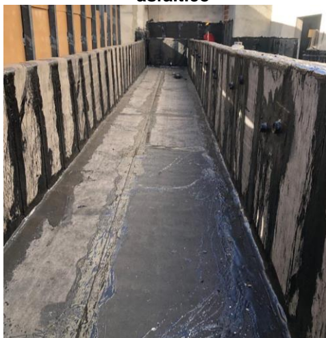
Figura 32 - Piscina após banho asfáltico
