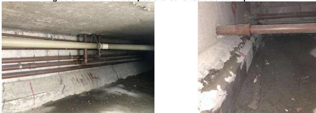
Figura 31 - Vazamentos após o terceiro teste de estanqueidade
