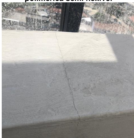
Figura 36 - Trinca na argamassa polimérica semi flexível
