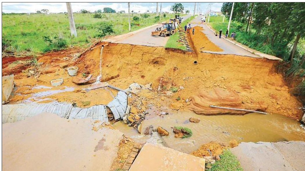
Figura 1 – Adutora de água tratada na Avenida Independência destruída pela chuva em 12 de fevereiro de 2022
