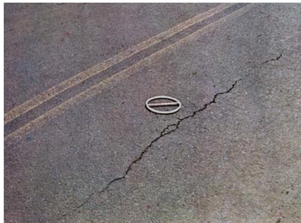
Figura 3 – Trinca isolada longitudinal [9]
