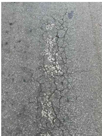
Figura 11 – Trinca couro de jacaré.
