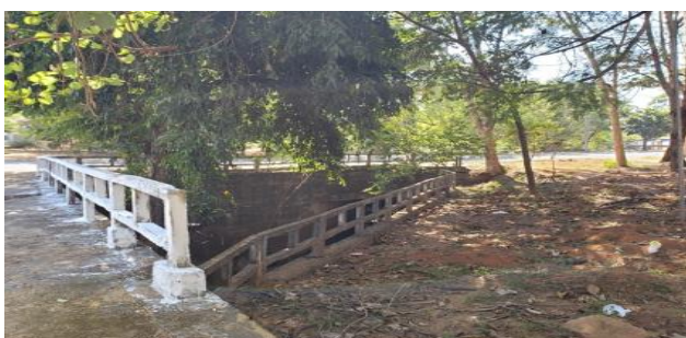
Figura 6 - Área impermeabilizada na margem e ponto de enchentes.
