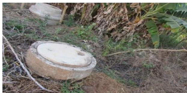
Figura 13 - Segundo poço de visita com sinais de vazamento (Prefeitura Municipal de Goianésia, 2022)
