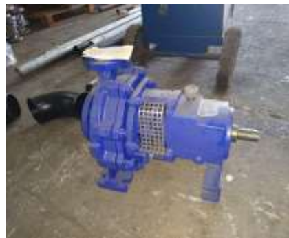
Figura 13: Bomba reserva das colunas
