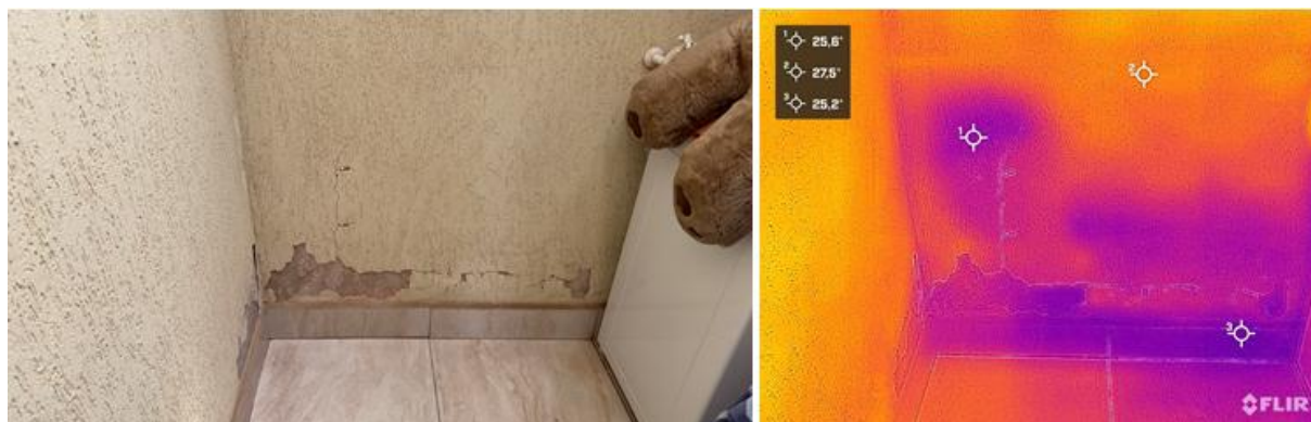
Figura 2. Parede da área de serviço da edificação 3.
